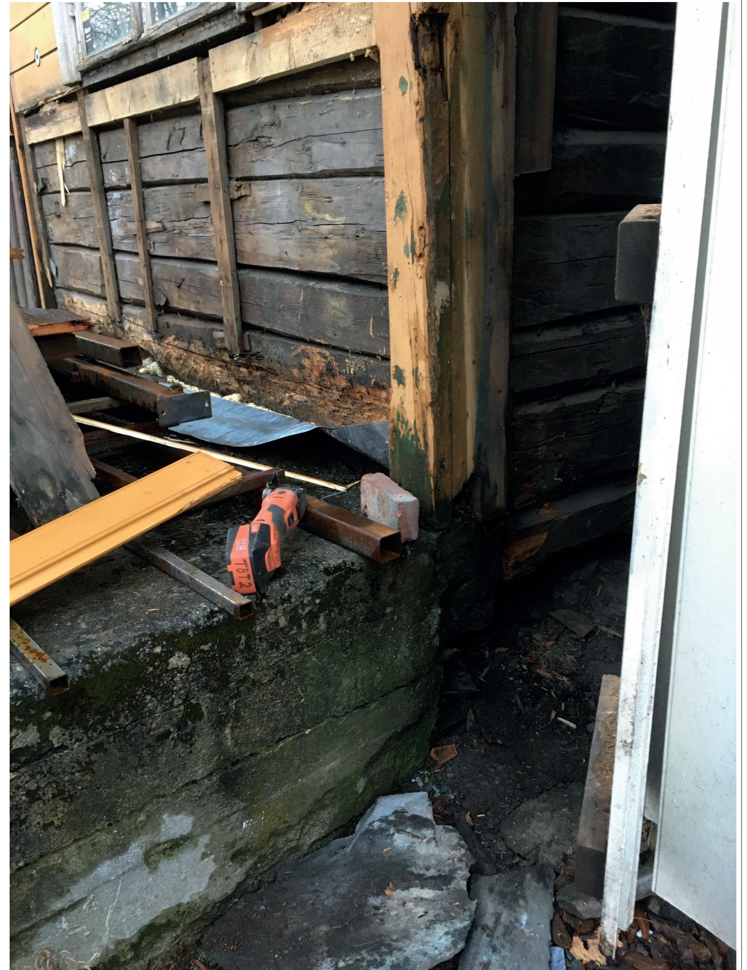
Foto viser sørvestre hjørne på Sørbrygga med store råteskader på laft. Betongrampen ses i forgrunnen til venstre.
