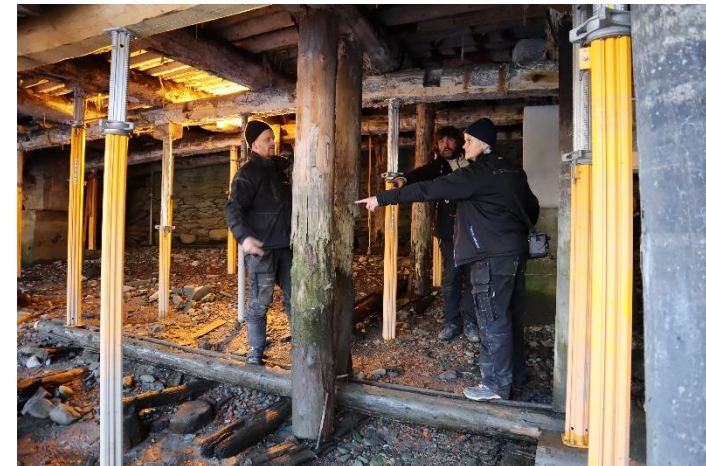
17 A. Stolper og bindebjelke reetableres ikke mellom bunnstokk 4 og 5. Stolpene står mot dragere og ikke bindebjelke, og er trolig satt opp slik i en senere reparasjon.
