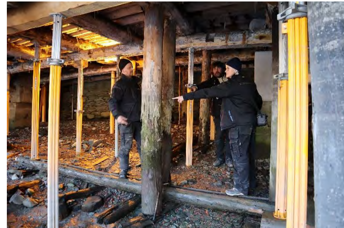
17 A. Stolper og bindebjelke reetableres ikke mellom bunnstokk 4 og 5. Stolpene står mot drager og ikke bindebjelke, og er trolig satt opp slik i en senere reparasjon.
