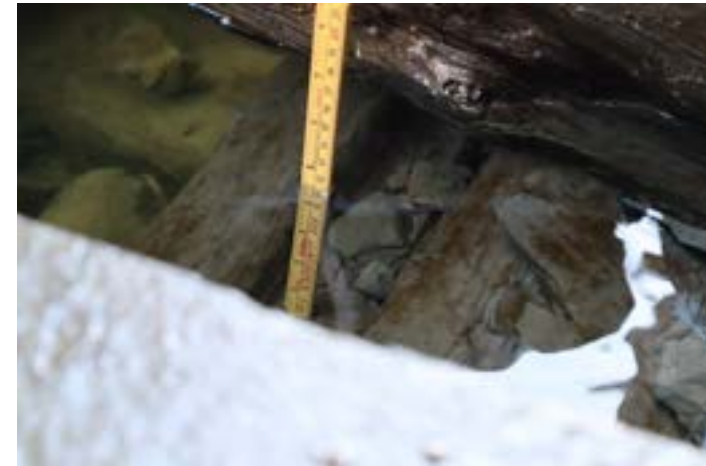
13. Midtbrygga. Eksisterende bunnstokk 2 må muligvis skiftes da tilstanden er ukjent. Benyttes hvis mulig.
